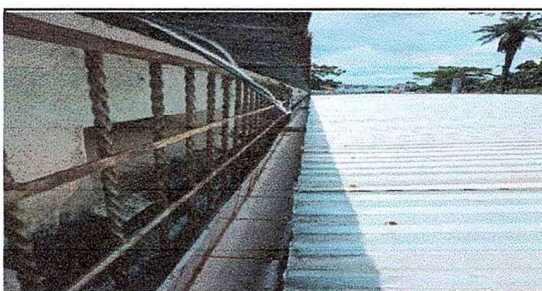
Foto 4: Canales revestidos con azulejo, para evitar la infiltración de agua y la correcta evacuación del agua de lluvia.
